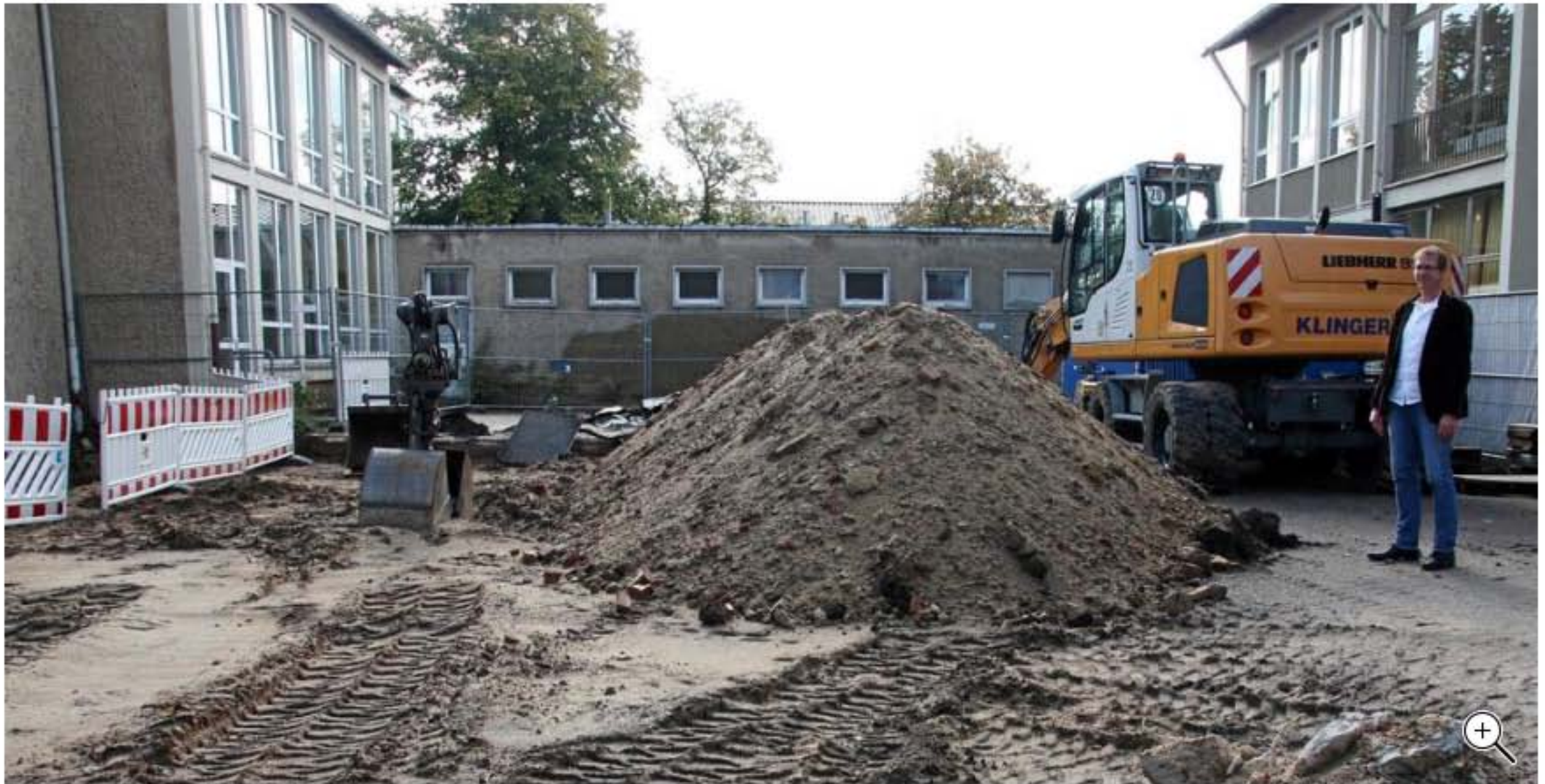
CHRISTIAN LÜBKE, LEITER DER OBERSCHULE DER EICHENDORFFSCHULE, AUF DER BAUSTELLE ZWISCHEN DEN GEBÄUDETRAKTEN EINS UND ZWEI. HIER ENTSTEHT BIS ZUM SOMMER 2020 EIN DRINGEND NÖTIGER NEUBAU. JÖRG KLEINERT
